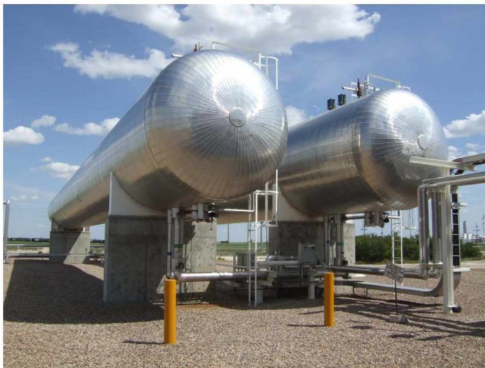
Figuur 4-5: Voorbeeld horizontale opslagtanks vloeibare CO 2
